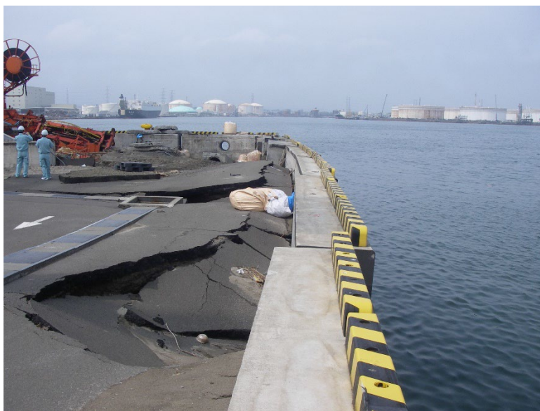
高砂埠頭 未改良箇所
